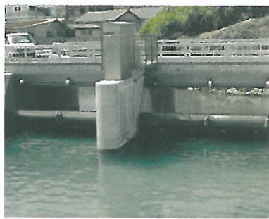
↑ 防潮水門・自動ゲート設備
